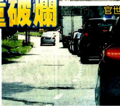
皇冠城2巷除了整片沥青脱落，也有不明显的路洞。
